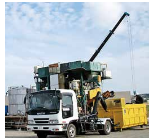
木質加熱アスファルトのプラント
