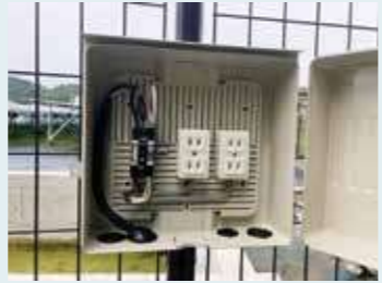
非常電源コンセント
